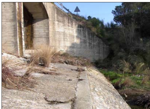
OD2.1: Viaducte de la riera Salenys C-65 (enllaç Alou - Santa Cristina d'Aro). PK 5 + 910 a 5 + 940
